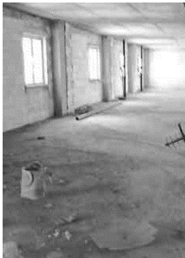
L'ospedale Un'ala ancora in costruzione che potrebbe aver favorito l'irruzione dei ladri
